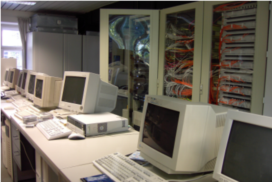
Abbildung 1: Serverraum: Einige Server mit Kabelschrank und Klimaanlage
